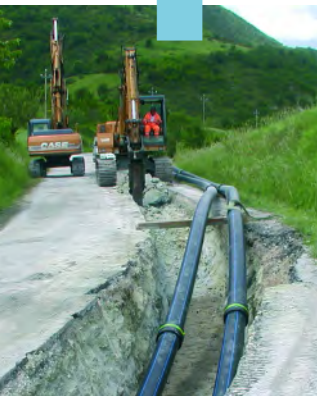
Condotte sorgente Montenero
