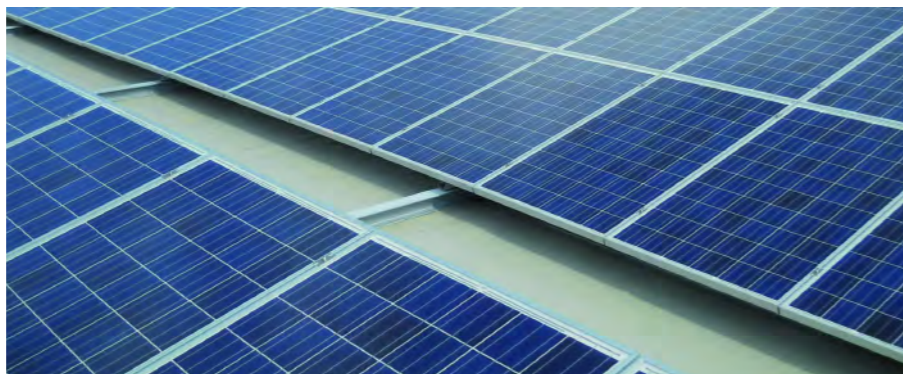
Pannelli solari serbatoio di Jesi
